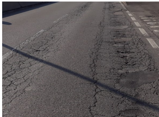
Fotogramma 1 - Esempio di degrado ormaie e deformazioni
