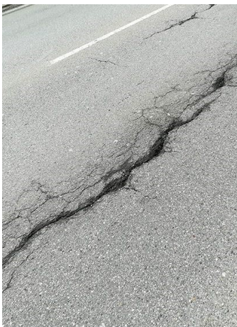
Fotogramma 2 – Esempio di degrado - fessurazioni
