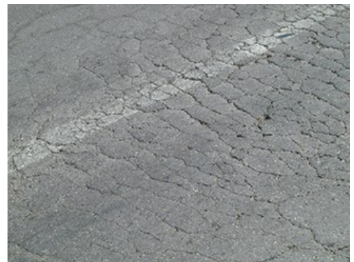
Fotogramma 3 - Esempio di degrado deformazioni
