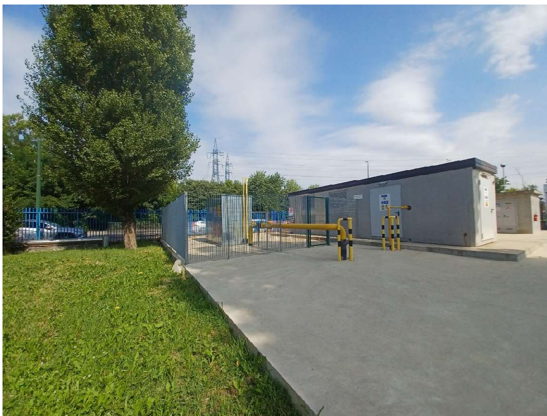
Fotografia 13 – Ingresso cabina RE.MI. – Data 23.07.2025
