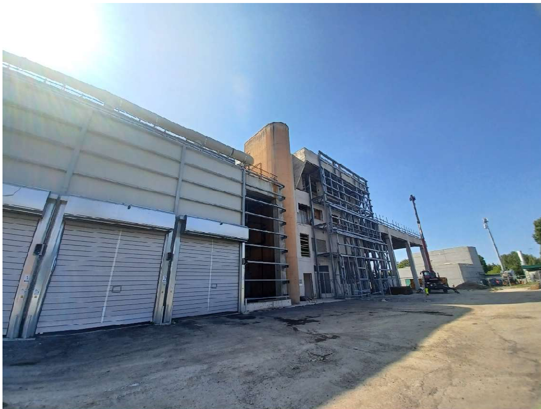
Fotografia 8 – Edificio sala controllo – Data 23.07.2025
