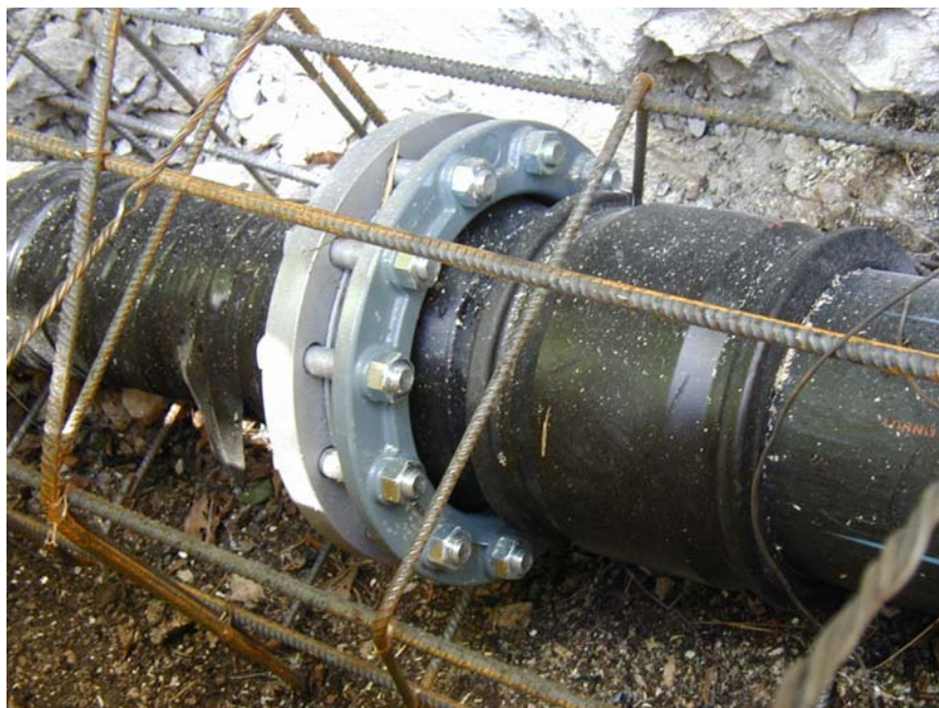
Esempio di tubo dell'acquedotto.
