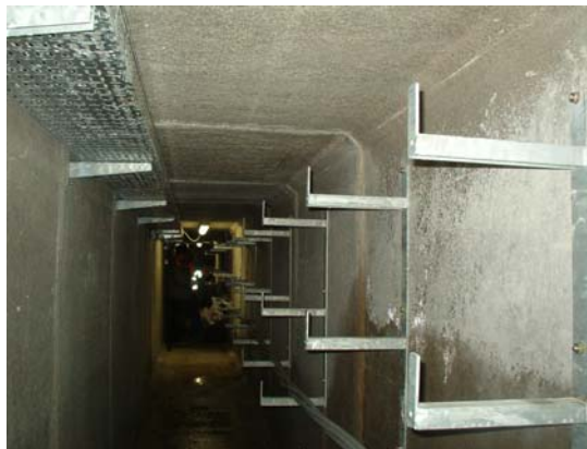
Galleria tecnologica predisposta per l'alloggiamento delle reti
